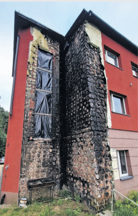
Od pożaru w budynku przedszkola i żłobka minęło półtora roku, ale miasto nie kiwnęło nawet palcem aby naprawić uszkodzenia spowodowane przez ogień.
